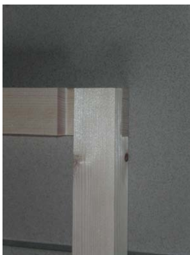
Abb. 2 Ofen links neben Tür Aufbau siehe B in Abb. 1, Ecke oben rechts
